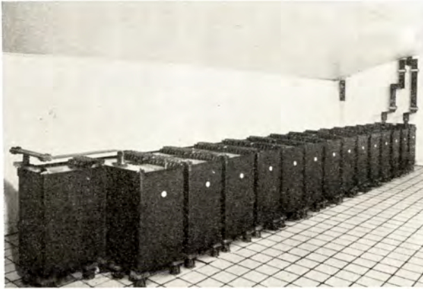
Akkumulaattoriparitot Keskustan maanalaisessa osassa: automaattikeskusten voimallähde
